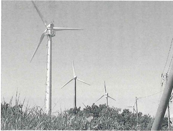
汐見地区の小形風力発電設備
