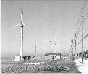
町内に建設された小形風車
