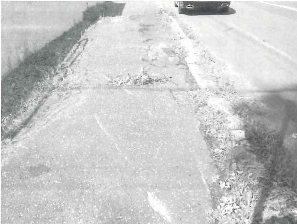
補修が必要と思われる歩道
