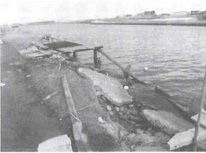
損壊が激しい福寿川護岸物揚場
