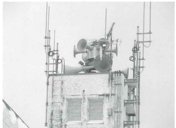
屋外への周知スピーカー（消防署屋上）
