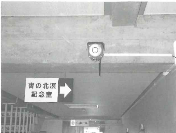
中央公民館設置の「防犯カメラ」
